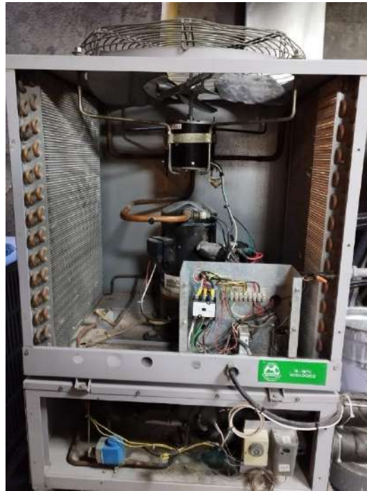
Figura 10. Equipo en correcto funcionamiento.
