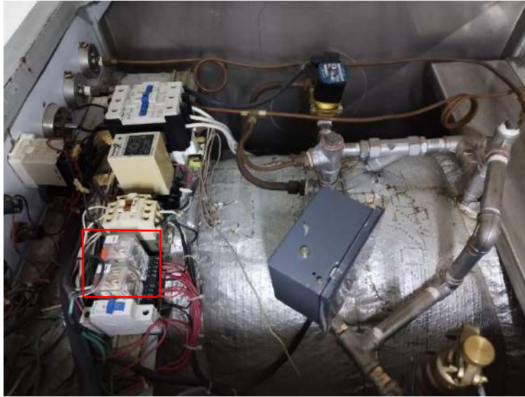
Figura 1. Relé calcinado, autoclave no arranca.
