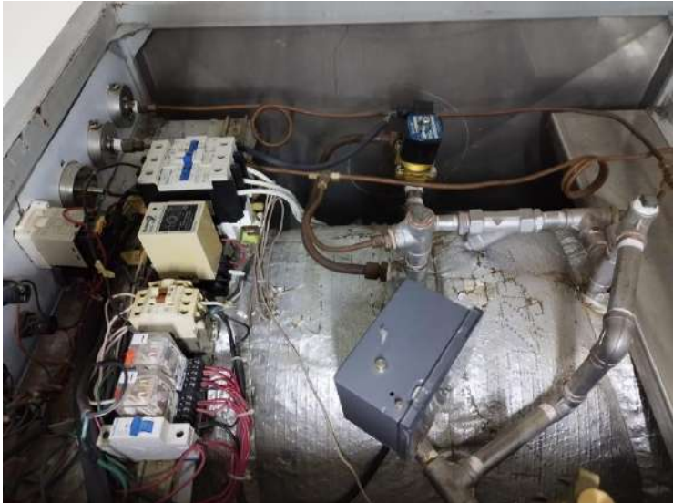
Figura 2. Cambio del relé calcinado
