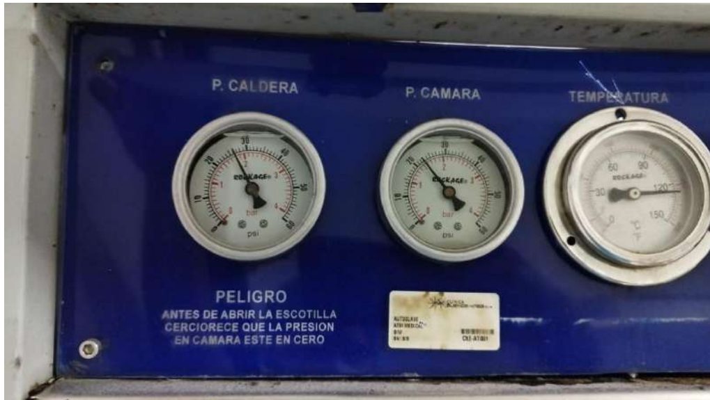
Figura 5. Manómetros de presión de la Caldera y la cámara.
